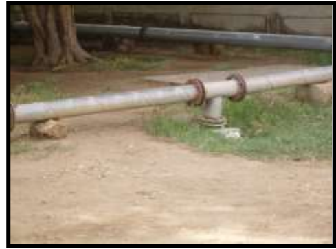
صورة (٣) مواسير الطرد من محطة المياه
